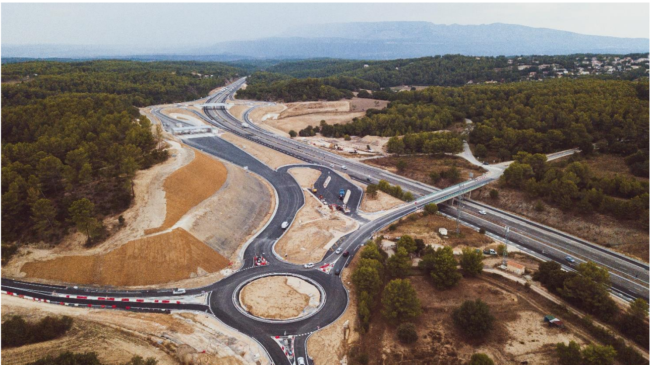
Au premier plan, le nouveau giratoire réalisé cet été qui connectera à terme le réseau secondaire avec le nouvel échangeur (Photo : Guilhem Canal)
